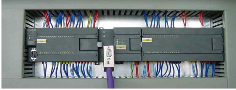
Resim 1.11: Bir PLC'nin pano içerisindeki i
